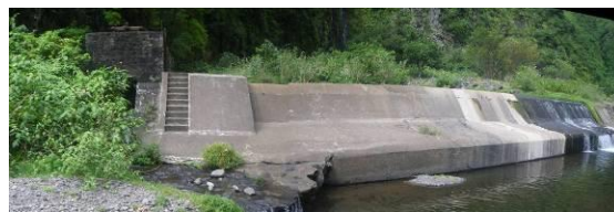
Seuil de captage de Bellepierre
